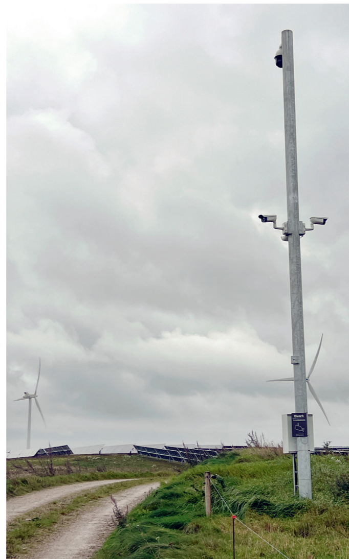
I den 90 hektar store Solparken Vejling er hegnest erstatet af højt udviklede kameraer, styret af kunstig intelligens, som overvåger arealet døgnet og året rundt. Dette kamera på denne mast står ved eneste adgangsvej og har også en nummerpladescanner.
